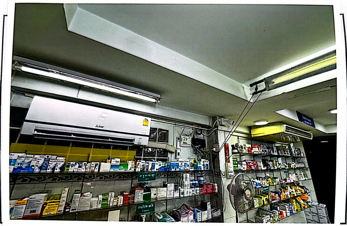
17. เครื่องปรับอากาศ
